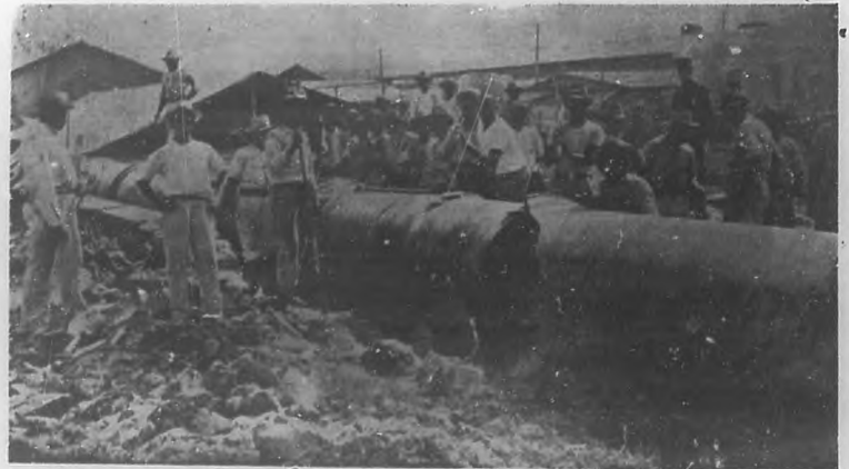
La cañería del acueducto de Vento, que con su ruptura privó a la Ciudad del precioso líquido.
